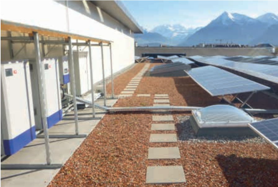
Abbildung 8: Kabelführung PV-Anlage zu Wechselrichter, Quelle: contec
