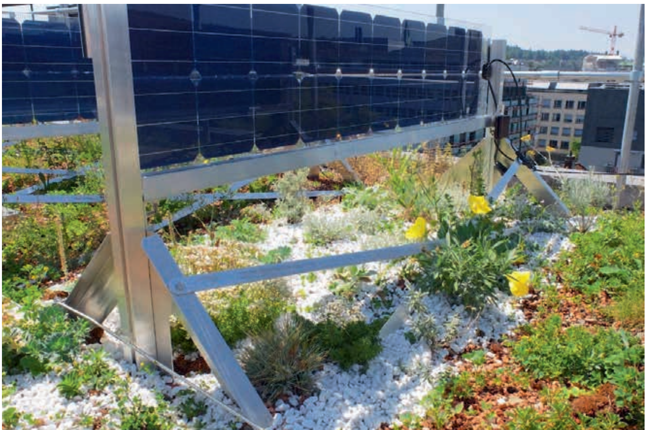
Abbildung 18: Testanlage der ZHAW, Quelle: Solarspar
